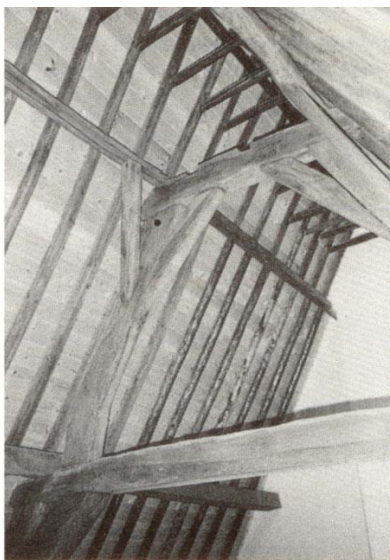
35. Lievevrouwestraat 45. Detail van de kap met toegevoegde nokgording.
